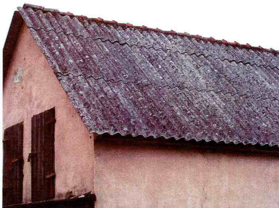
Ryc. 17. Dach budynku gospodarczego pokryty płytami cementowo - azbestowymi. Fot. Małgorzata Wojtan.
