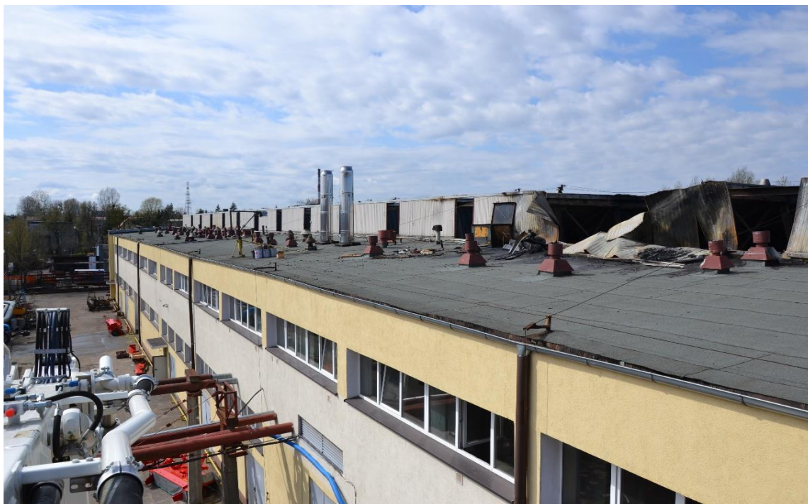
Famarol – uszkodzenia dachu po pożarze.
