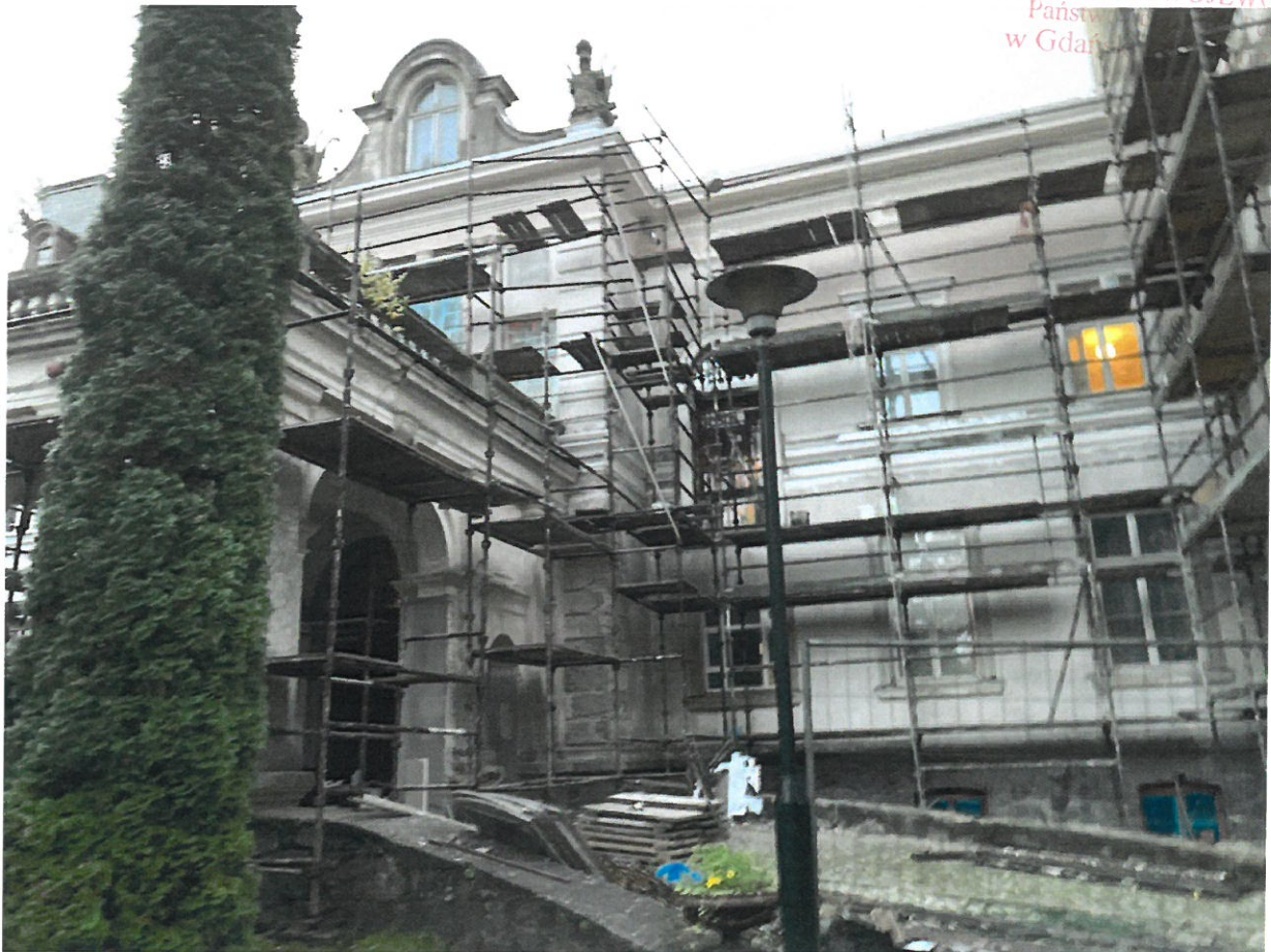
Rys. 4: Krzew, lampa i taras utrudniające dostęp do elewacji
