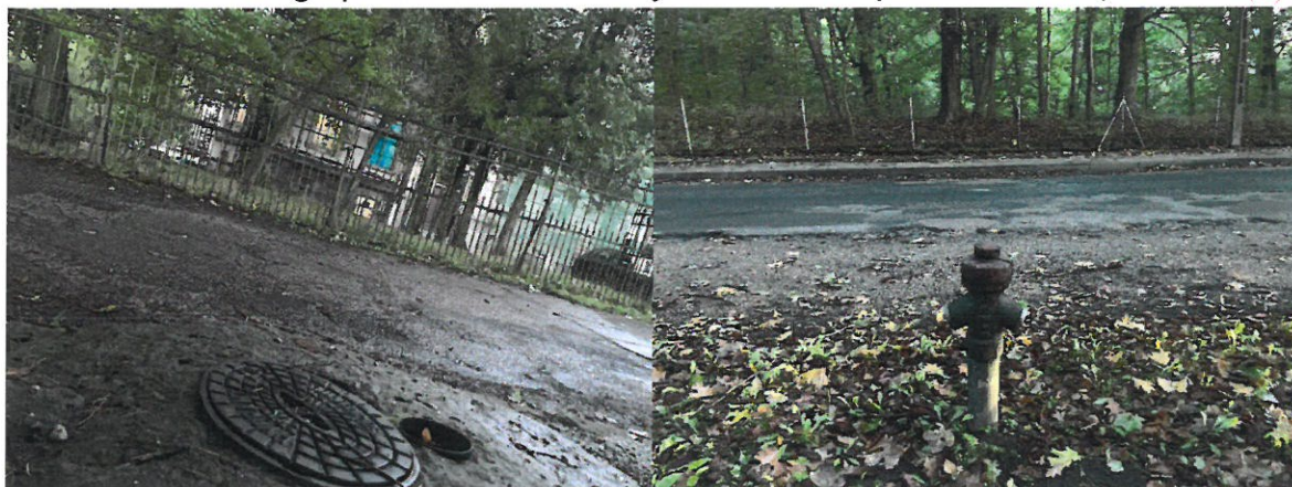
Rys. 7: Hydranty zewnętrzne dla budynku
