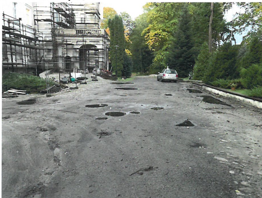
Rys. 3: Istniejący układ drogowy na terenie SOSzW w Damnicy – układ drogowy będzie utwardzony (utwardzenie wg. części graficznej) – w tle widać lampy, krzewy i zabytkowy taras utrudniające dostęp do elewacji
