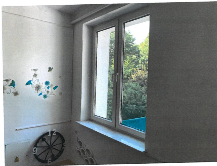
Rys.2: Okno przeznaczone do oddymiania klatki schodowej
