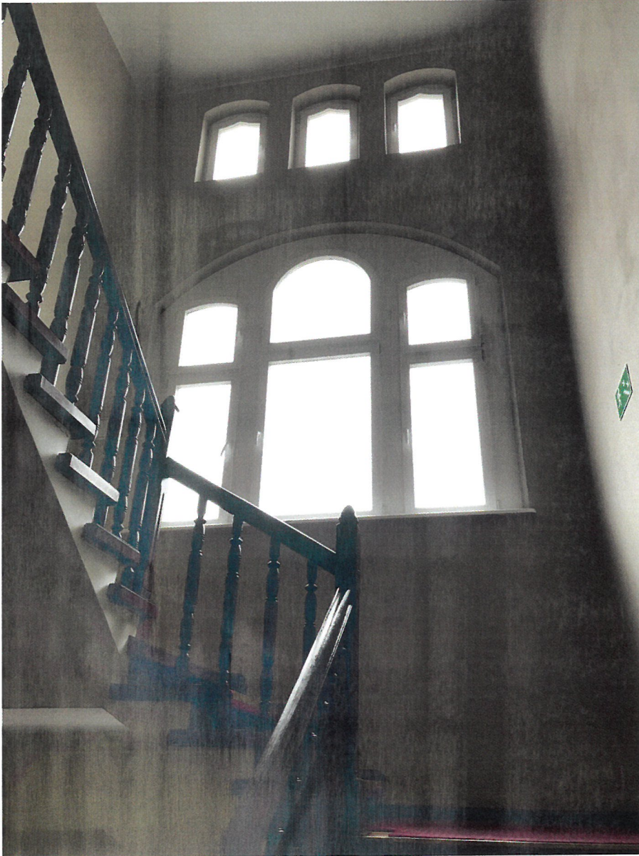
Fot. Górne okna (3 sztuki) na klatce K2 zostaną przystosowane do oddymiania.
