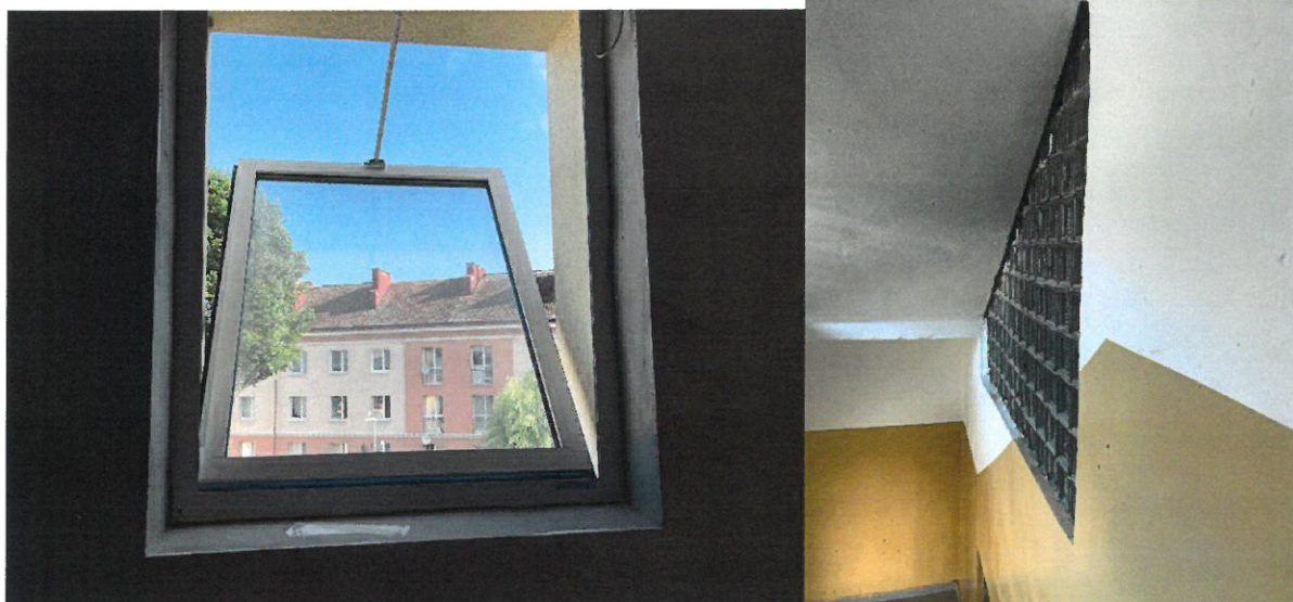
Rys.5: okno oddymiające oraz luksfery na klatce schodowej obudowane płytą o nieznanym poziomie odporności ogniowej.
