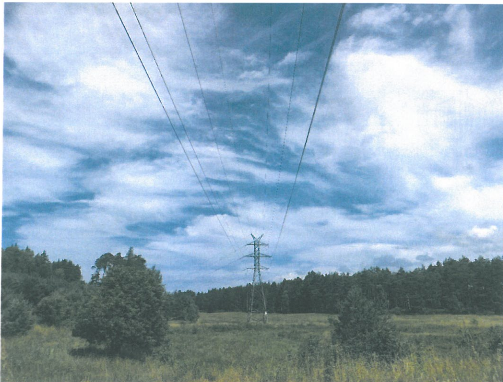
Zdjęcie nr 2. Dwutorowa napowietrzna linia elektroenergetyczna 110 kV relacji GPZ Ustka – GPZ Rowy – widok fragmentu linii.
