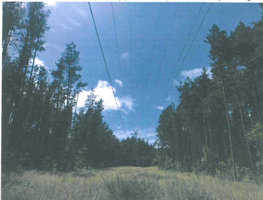
Zdjęcie nr 3. Dwutorowa napowietrzna linia elektroenergetyczna 110 kV relacji GPZ Ustka – GPZ Rowy – widok fragmentu linii.
