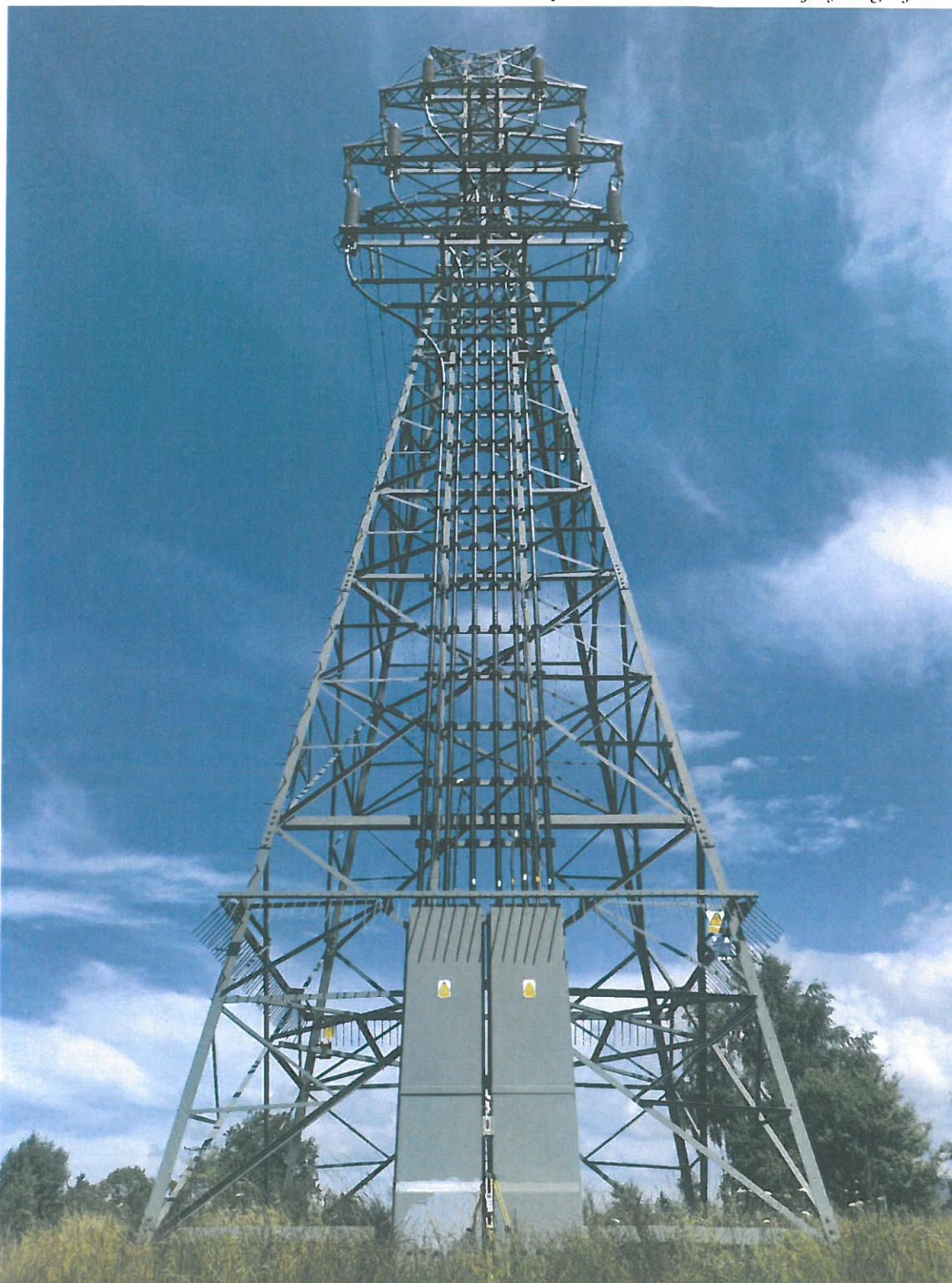
Zdjęcie nr 1. Dwutorowa napowietrzna linia elektroenergetyczna 110 kV relacji GPZ Ustka – GPZ Rowy - słup kablowy nr 96.
