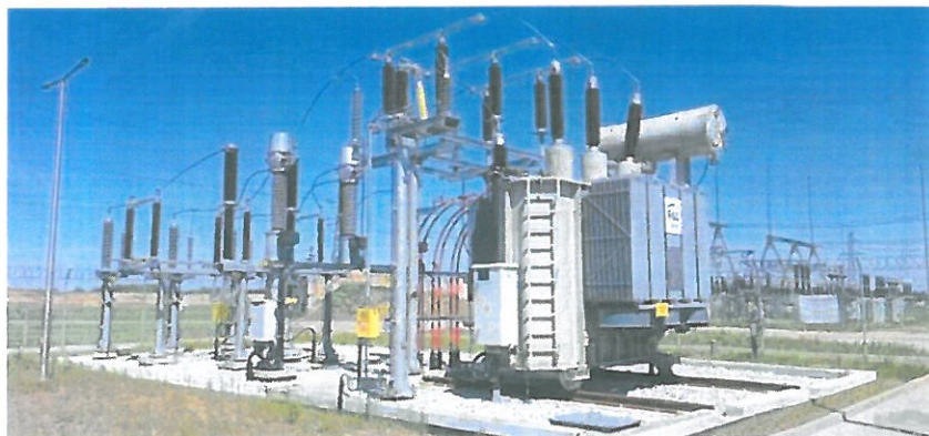
Rozdzielnia napowietrzna – pole transformatora i linii 110 kV
