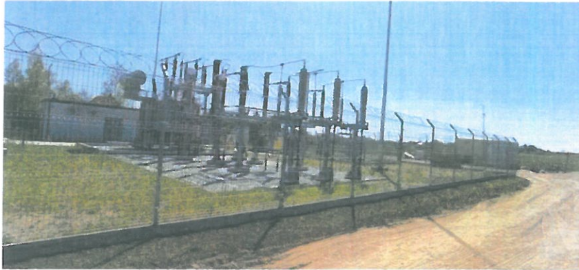
Otoczenie stacji elektroenergetycznej 110/20 kV GPO FW Grąbkowo
