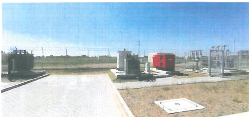
Dławik, transformator uziemiający i bateria kondensatorów
