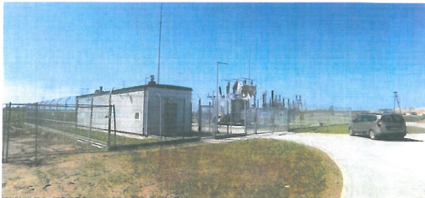
Otoczenie stacji elektroenergetycznej 110/20 kV GPO FW Grąbkowo
