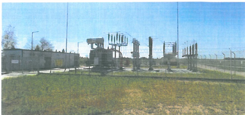
Otoczenie stacji elektroenergetycznej 110/20 kV GPO FW Grąbkowo
