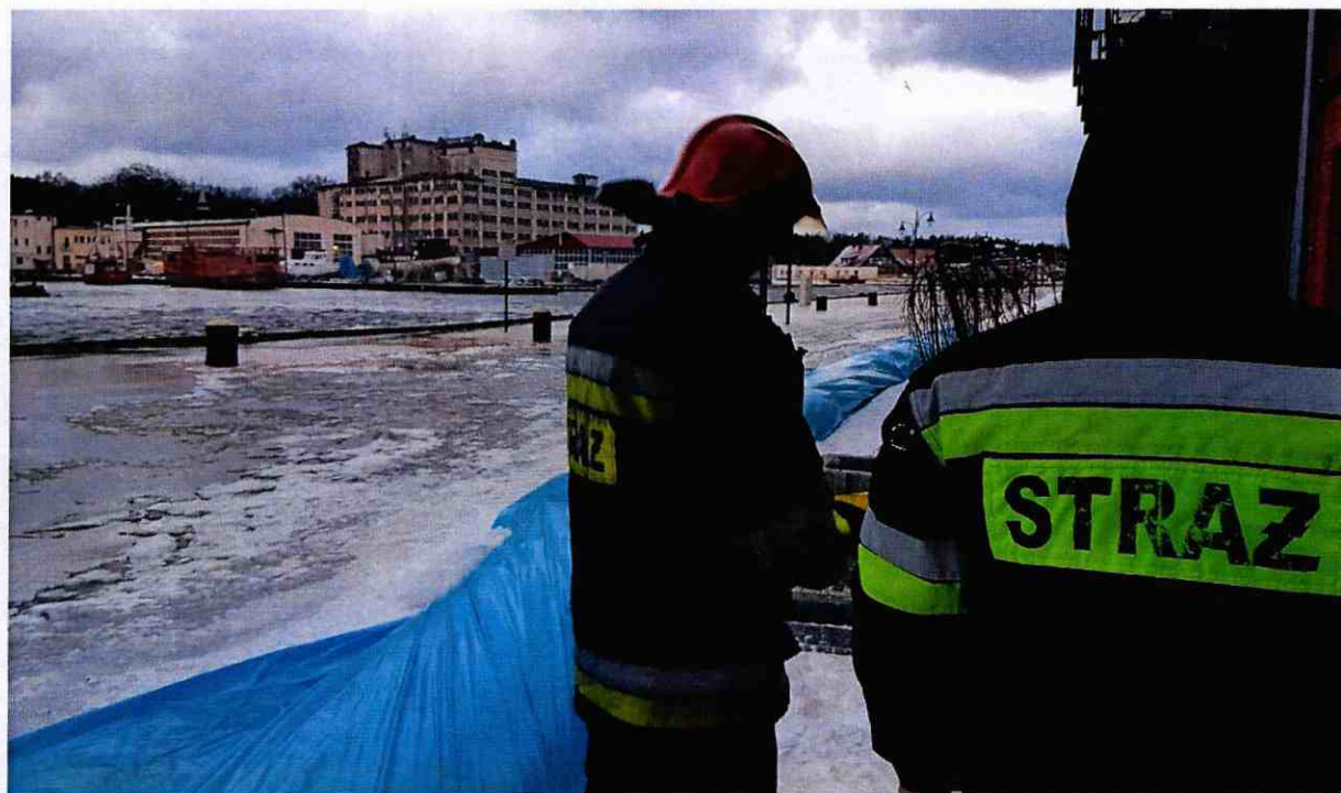
Nabrże portowe w Ustce zabezpieczone za pomocą rękawów przeciwpowodziowych (fot. KM PSP w Słupsku).
