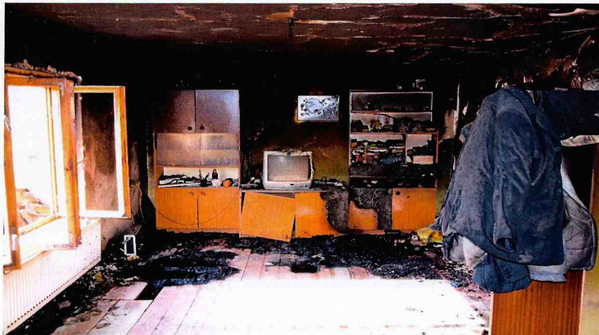
Pożar budynku mieszkalnego w Szczypkowicach (Fot. st. ogn. Rajmund Dargas)
